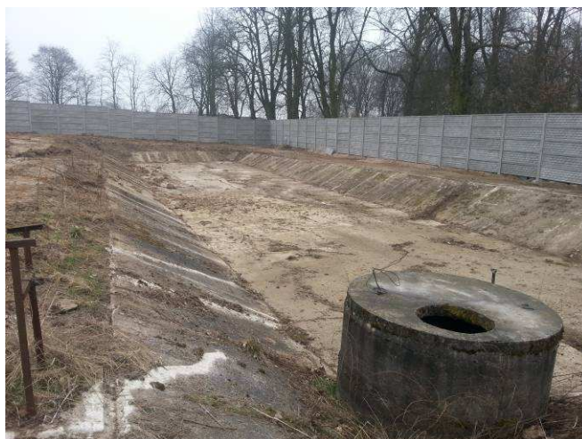
Zdjęcie 5.2 - 7 widok istniejącego w południowej części działki nieszczelnego zbiornika powierzchniowego opisanego powyżej.
