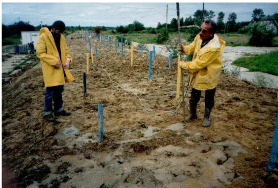
Rys.6.1.1 - 2 przykładowy widok pryzmy bioremediacji z zamontowanym systemem napowietrzania
